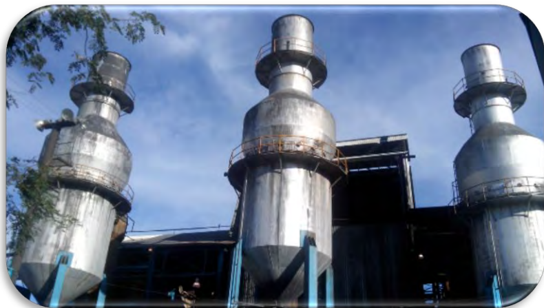
Paraklones: Calderas 3, 4 y 5
